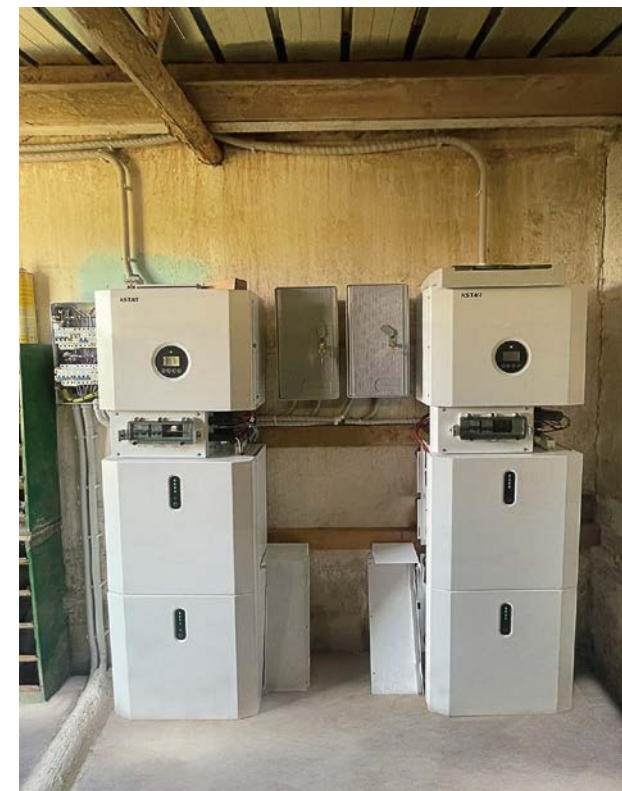
05 ESS-Projekt für Wohnhäuser in Italien
