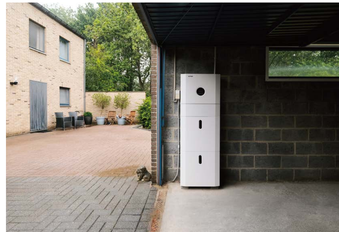
11 ESS-Projekt für Wohnhäuser in Belgien
