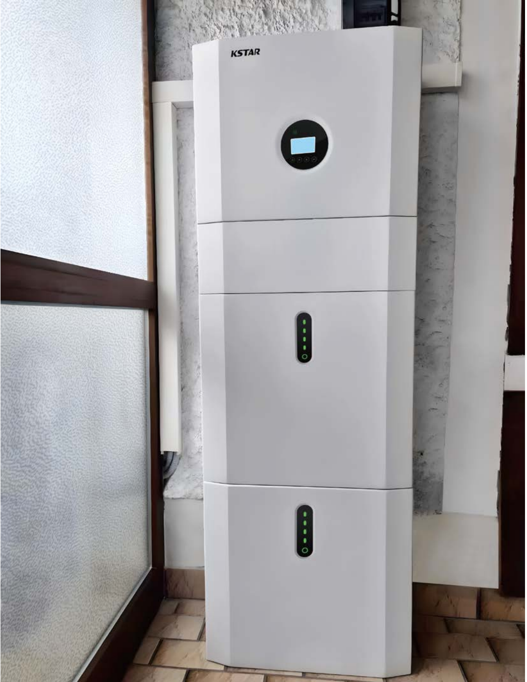
02 ESS-Projekt für Wohnhäuser in Italien
