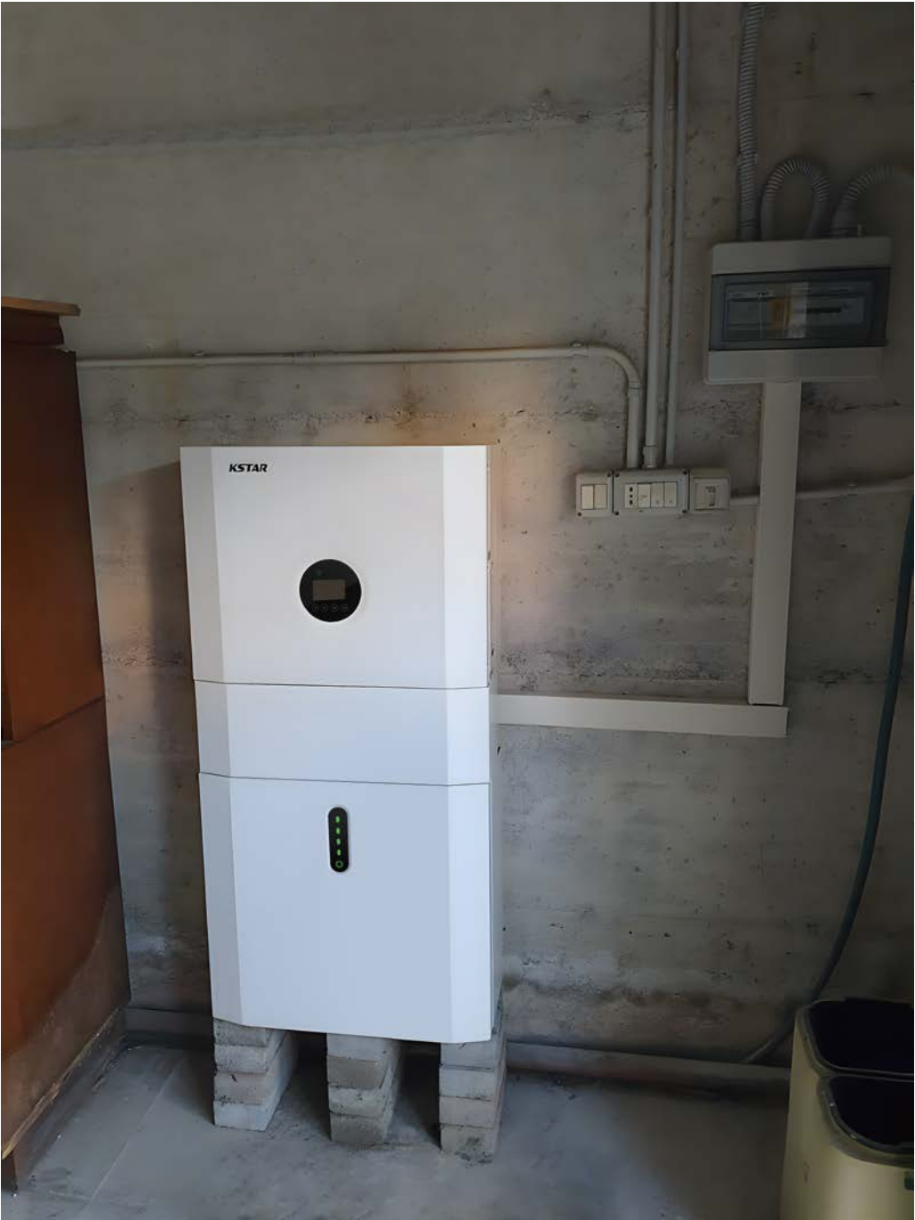
01 ESS-Projekt für Wohnhäuser in Italien
